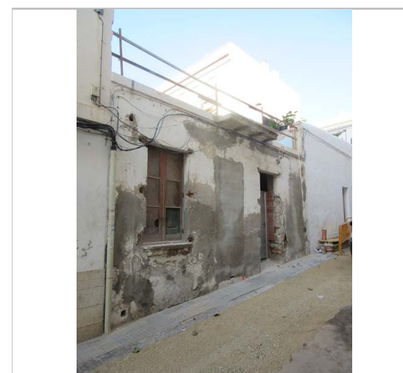
La casa a mig enderrocar. 21.10.2015 JM. Pujol
