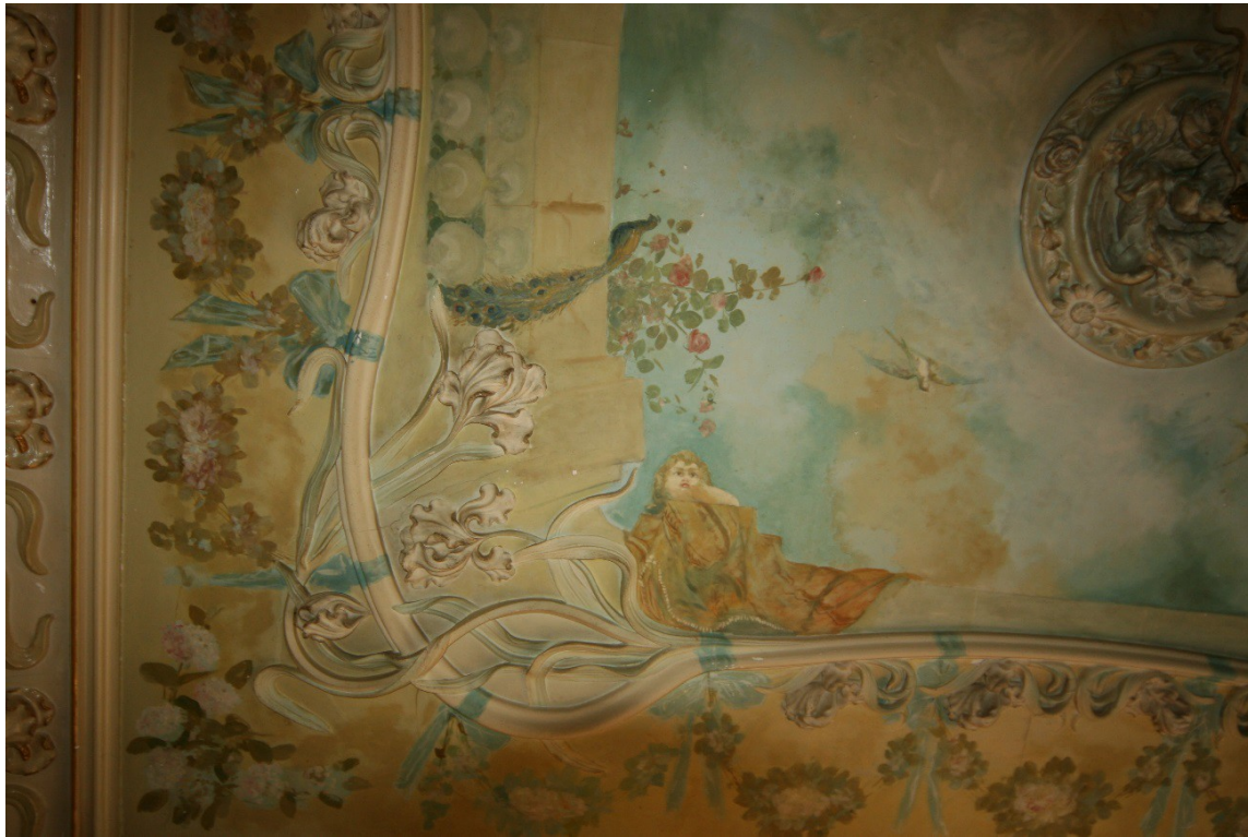
Sostre del menjador de la Casa Bonaventura Blay. Arquitecte Gaietà Buïgas Monravà.
