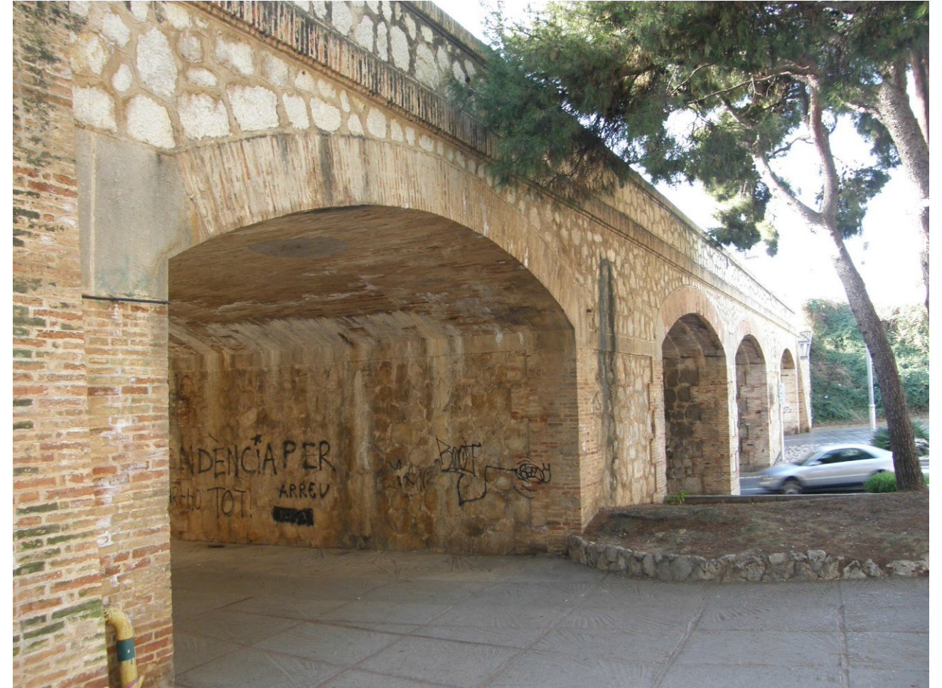
El pont ferroviari de Can Perico fa aprox. 50 m de llarg i 20 m d'ample i suporta quatre línies fèrries, salvant un desnivell de 4,30 m.
