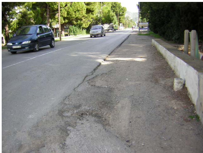
Estat de les voreres del Pg. de Vilanova.
